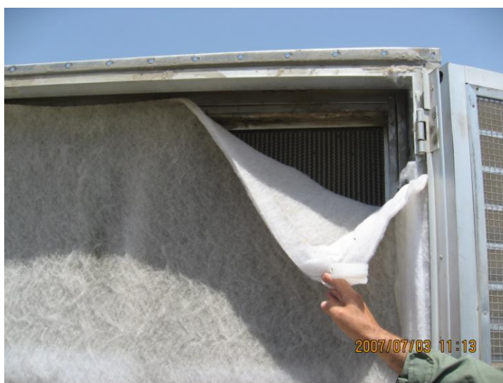
شکل ۸- نمایی از فیلتر هواساز تونل پاستوریزاسیون بستر رویش قارچ دکمه ای
