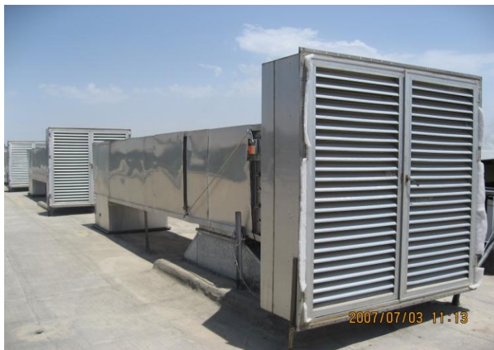
شکل ۷- نمای استقرار هواساز روی بام تونل پاستوریزاسیون بستر رویش قارچ دکمه ای مجهز به فیلتر هوا
